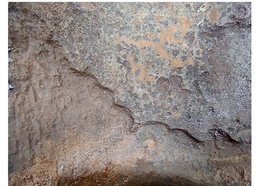
Рис. 2. Фото сегмента газопровода после первой ступени компримирования, очищенного от отложений. Фото авторов Fig. 2. Photo of the segment of the gas pipeline after the first stage of compression, cleared of deposits. Photo of the authors
