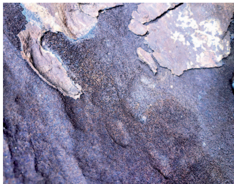
Рис. 1. Фото сегмента газопровода после первой ступени компримирования с отложениями. Фото авторов Fig. 1. Photo of the gas pipeline segment after the first stage of compression with deposits. Photo of the authors
